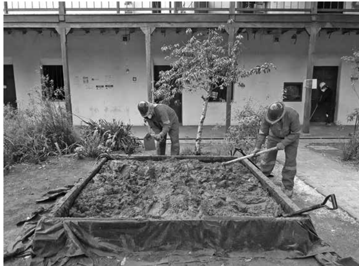
FIGURA 7. IMAGEN QUE MUESTRA LAS RECONSTRUCCIONES PARCIALES Y EL RESCATE DE ESTRUCTURAS DE MÚROS, ENTREPISOS Y TECHUMBRES. FUENTE: FOTOGRAFÍA DEL AUTOR DEL ARTÍCULO
