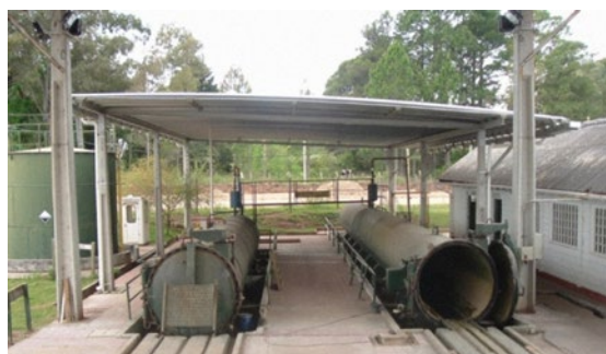
Figura 5. Zona de autoclaves.
