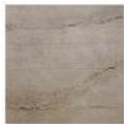
Fig. 1 Trozo de Hormigón
